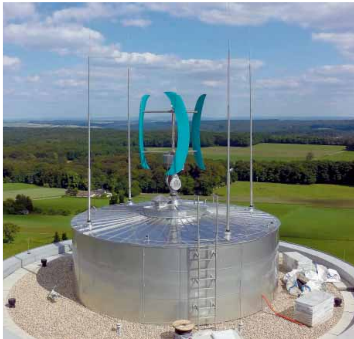
Eine Windkraftanlage des luxemburgischen Herstellers Swirl auf dem Wasserturm in Berdorf
